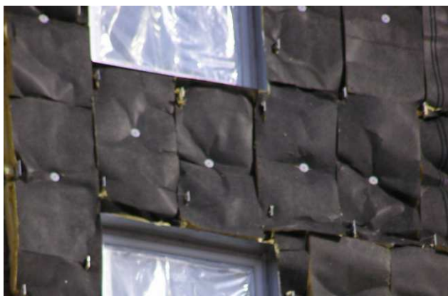
9. Отсутствие перевязки швов (п.9 табл.5)
